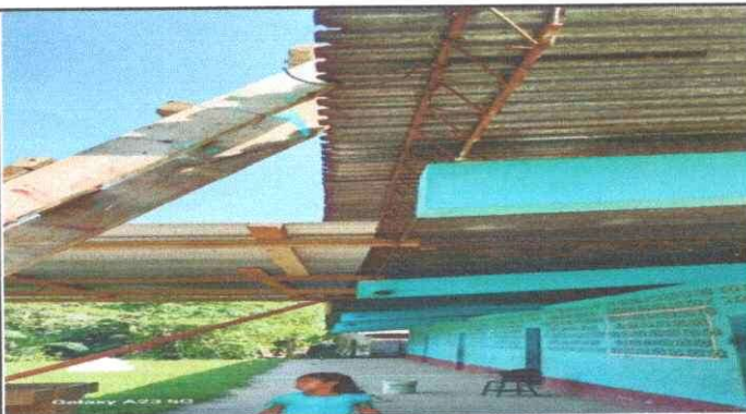
Foto 3: Se observa el deterioro de la estructura del MÓDULO 1.
